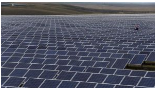
Paneles fotovoltaicos. EFE
