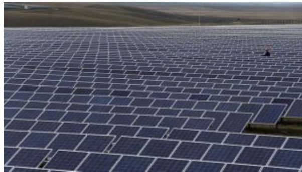
Paneles fotovoltaicos. EFE
