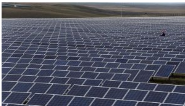
Paneles fotovoltaicos. EFE
